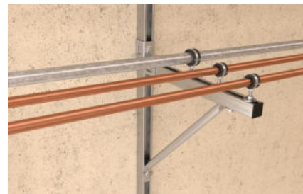
Lekkie rurociągi zamontowane na wsporniku
