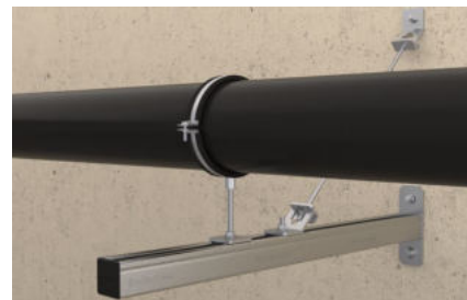
Ciężki rurociąg na wsporniku
