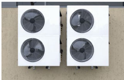
Klimatyzatory zamocowane na elewacji
