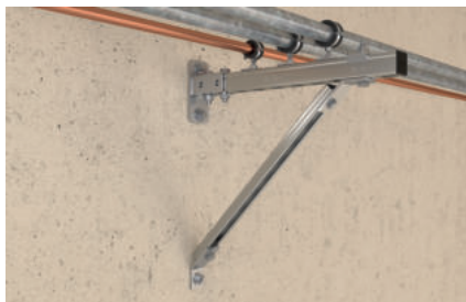
Lekkie rurociągi na wsporniku
