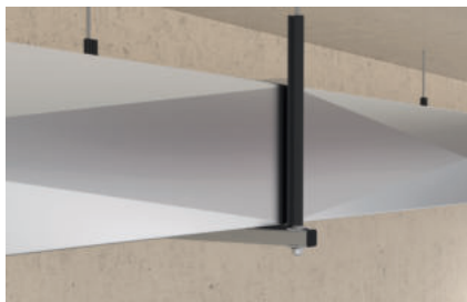
Kanał wentylacyjny osadzony na szynach montażowych
