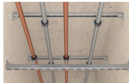
Mocowanie rurociągu w korytarzu
