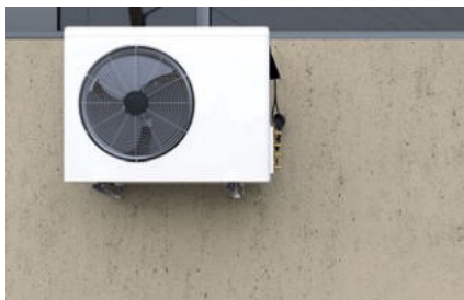
Klimatyzator zamocowany na ścianie
