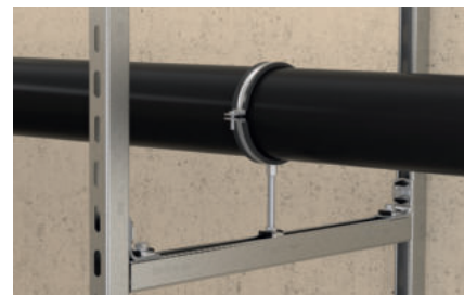
Rura zamocowana na konstrukcji wsporczej
