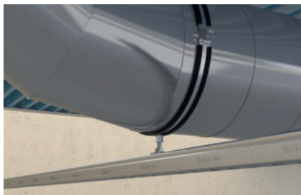
Konstrukcja wsporcza do wentylacji
