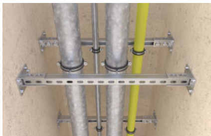
Rurociągi w przejściu ewakuacyjnym
