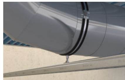
Konstrukcja wsporcza dla wentylacji
