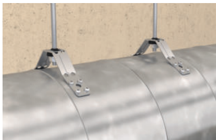
Spiralna rura wentylacyjna podwieszona na wieszakach z izolacją akustyczną
