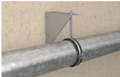
Rurociąg podwieszony na wsporniku kątowym
