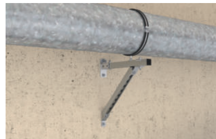
Kanał wentylacyjny na wsporniku
