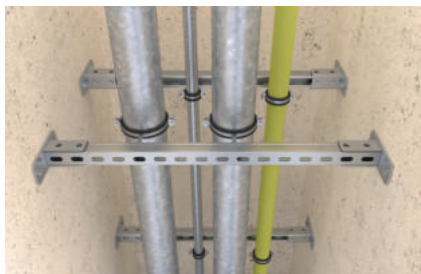
Instalacje mocowane w przejściu ewakuacyjnym
