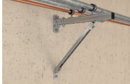
Lekkie rurociągi na wsporniku
