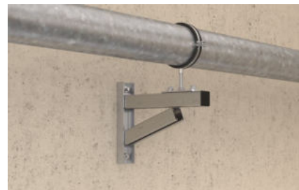
Rurociąg zamocowany na wsporniku
