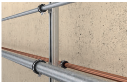
Równoległe rurociągi zamontowane na szynie montażowej
