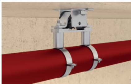
Punkt stały z izolacją, zamontowany do stropu
